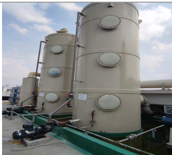
3#车间“酸吸收+碱吸收”（TA005）
