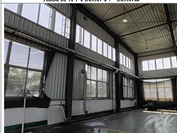
危废暂存间废气收集管道
