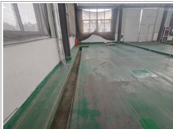
危废暂存间收集沟、收集池
