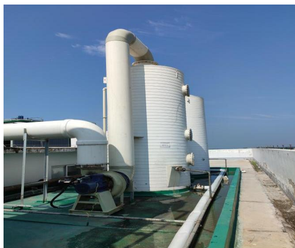
1#车间“碱吸收+水吸收”（TA001）
