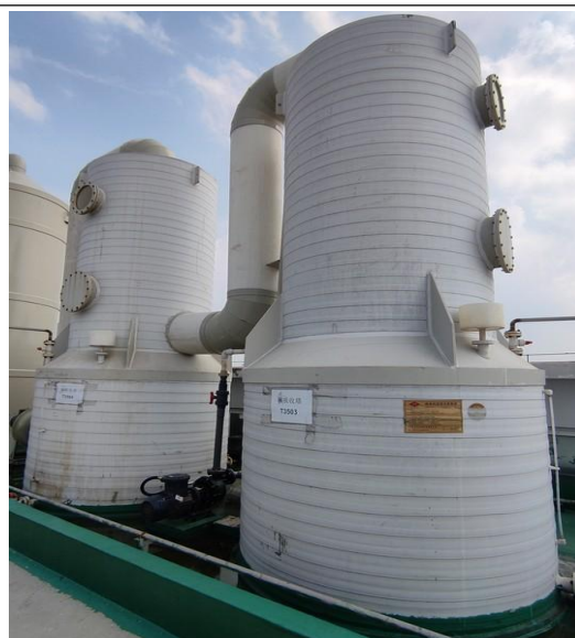
3#车间“碱吸收+水吸收”（TA004）
