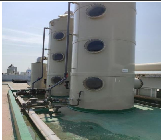
1#车间“酸吸收+碱吸收”（TA002）
