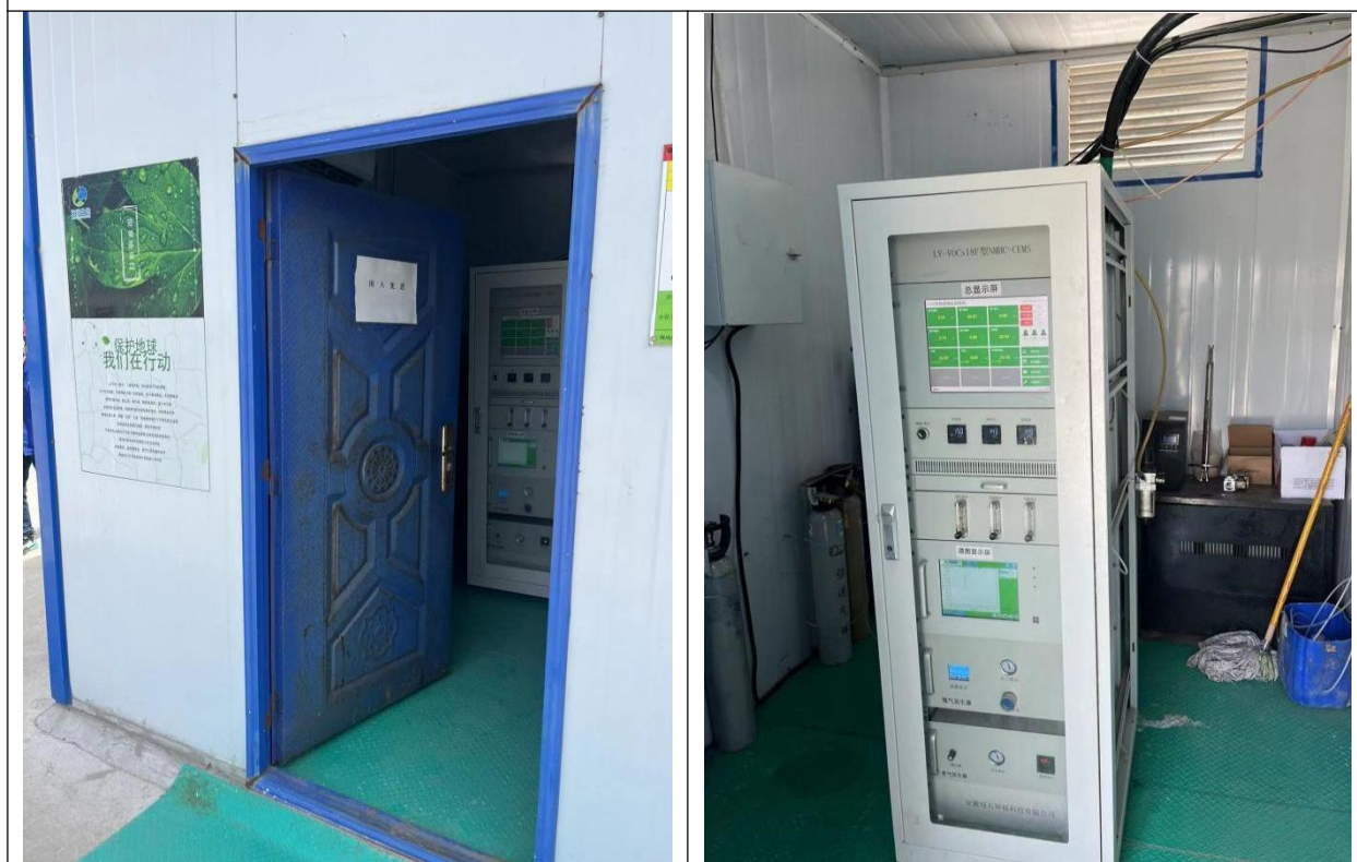
RTO 燃烧废气在线监测站房
