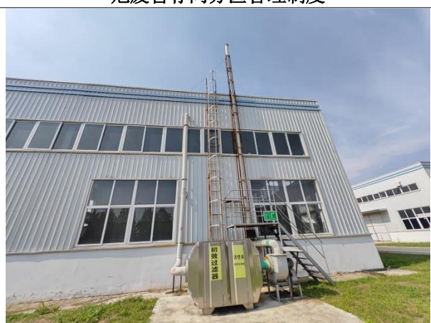
危废暂存间废气处理系统
